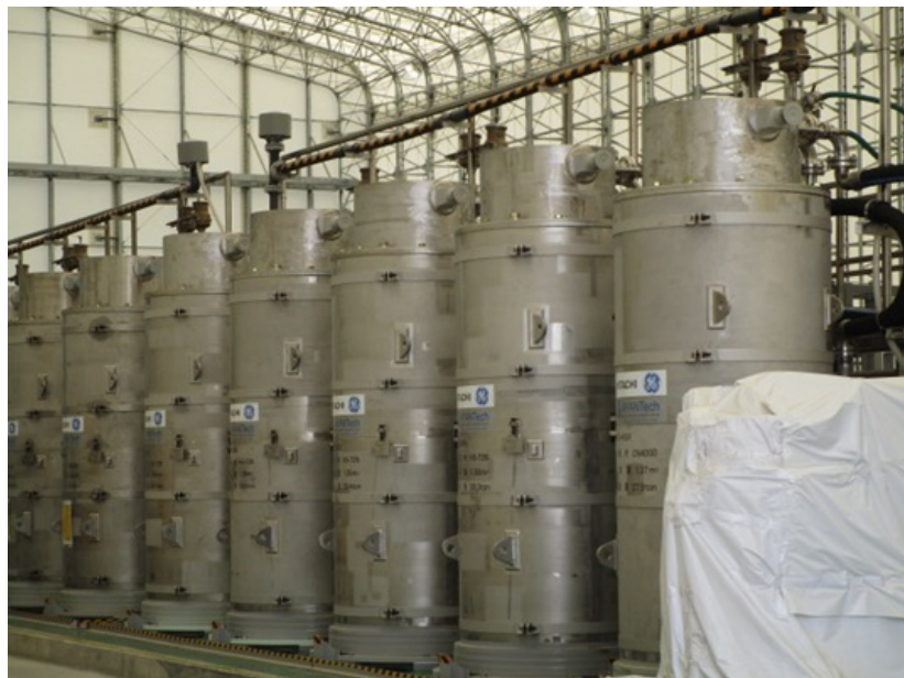
多核種除去設備 (ALPS)
